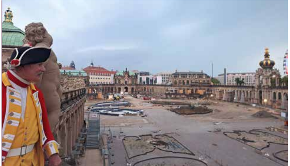
Baustelle im Dresdner Zwinger. Im Jahr 2025 soll der Zwingerhof wieder nutzbar sein.
